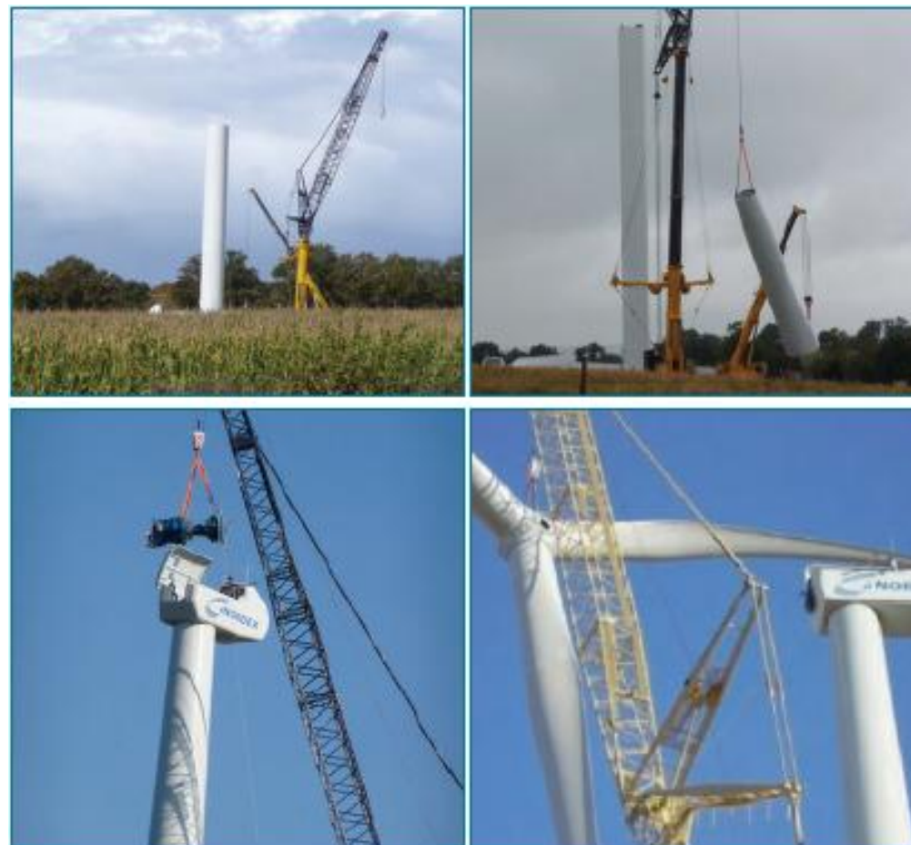
Figure 73 : Montage d'une éolienne par section - chantier de Crêtes et Fouy (49) (source : Nordex France S.A.S.)
